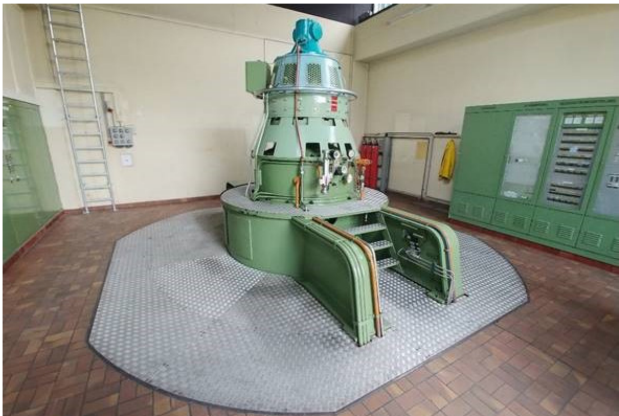
Maschinenhaus – Ansicht Generator
