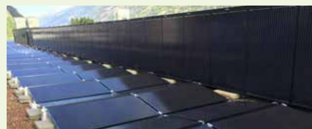
PV-Anlage Bahnhof Visp
