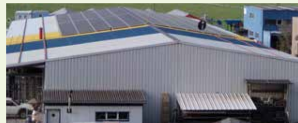
PV-Anlage Kalkofen, Gampel
