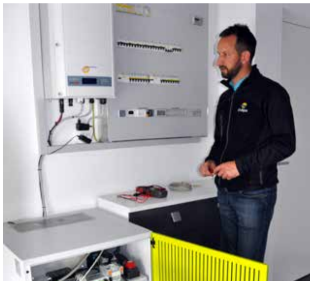
Technikraum Einfamilienhaus Stefan Wyss
