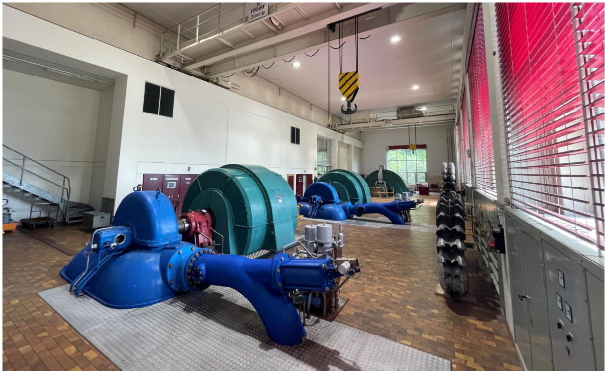
Maschinenhalle Kraftwerk Mörel
